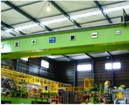
【導入事例】 旋回機能付き天井クレーン
