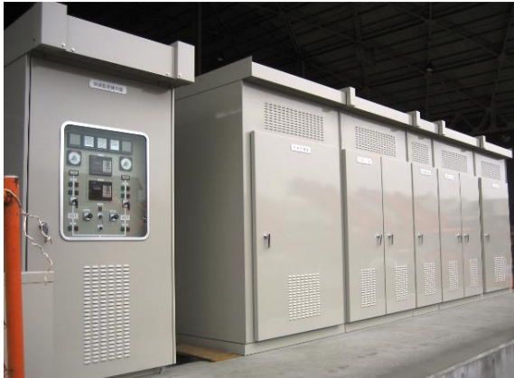
22kV特別高圧受電盤
